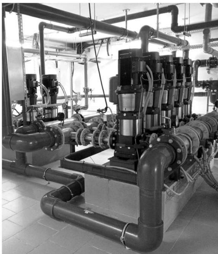
Работу на станции очистки воды контролируют цифровые технологии
