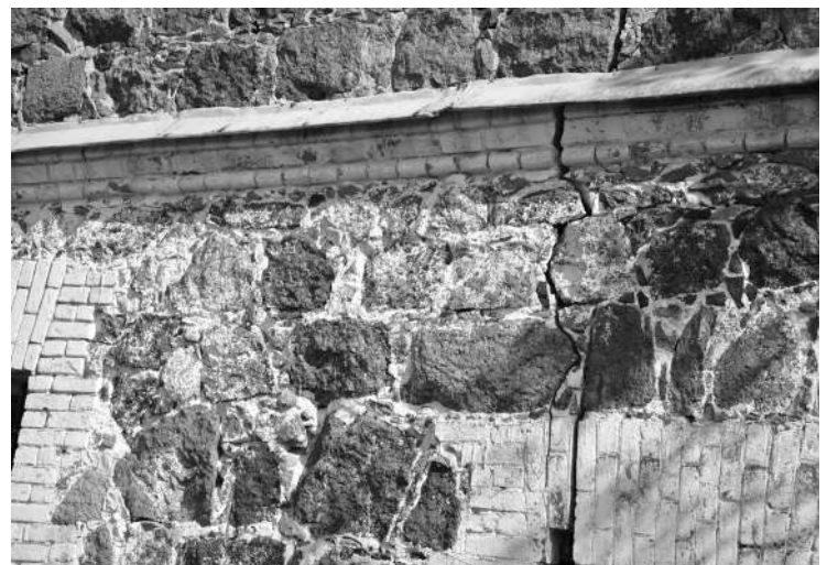
● Трещины в стенах башни
